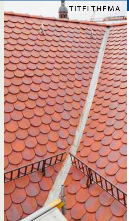
Die Kehlen des Biberschwanzziegeldaches wurden als Metallkehlen ausgeführt. Rundumlaufend montierten die Dachdecker Schneeschutzgitter.
