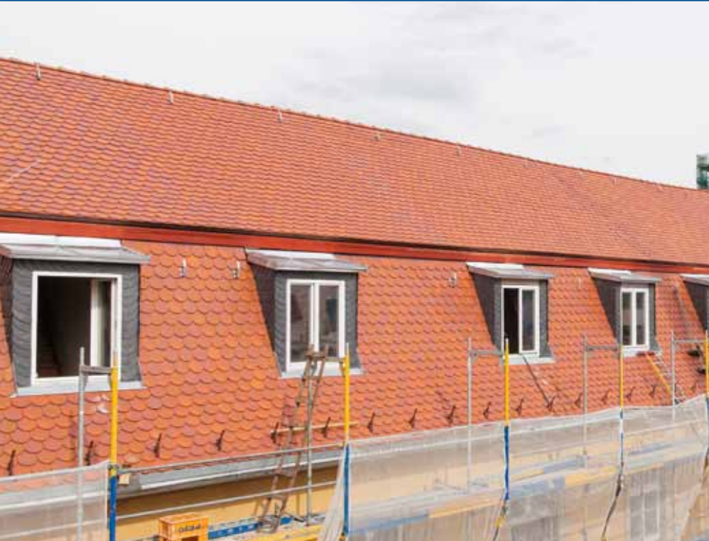
Die Gauben in den Mansardflächen erhielten eine Verschieferung. Anschlüsse und Übergänge zum Steildach wurden ebenfalls metallisch ausgeführt.
